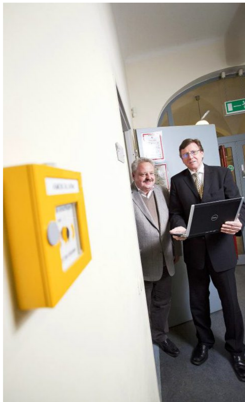
Test Schulleiter Gerhard König (l.) und Dietmar Bräuer von der Berliner Firma Tevitel, die das Alarmsystem am Max-Delbrück-Gymnasium entwickelt hat
